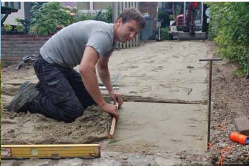
Hier egaliseert Booltink bouwzand als ondergrond voor honingraatplaten, die zwaar verkeer aankunnen. In en op de honingraten komt een laag goede grond, waarin gras wordt gezaaid.
