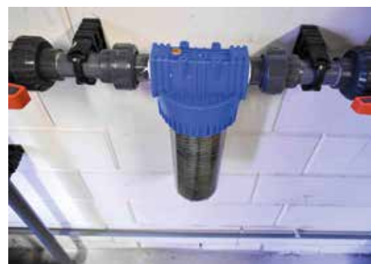
Het bronwater gaat in de schuur eerst door een demontabel voorfilter.
